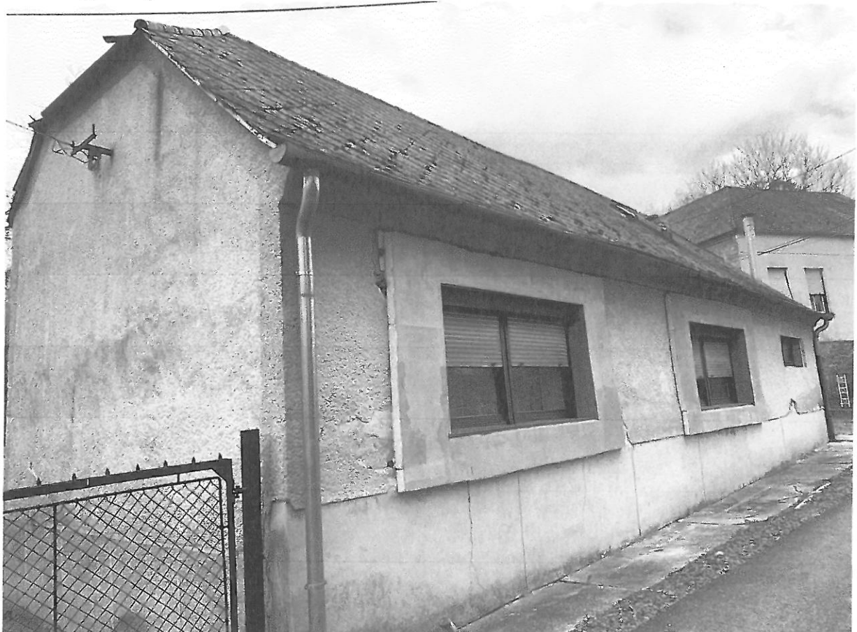
TARTÓSZERKEZETI SZAKÉRTŐI SZAKVÉLEMÉNY , Lakóépület állapt felmérés, Álló Judit, 7304 Mánfa, Forrás köz 5., hrsz.5219, 2020.06.23
