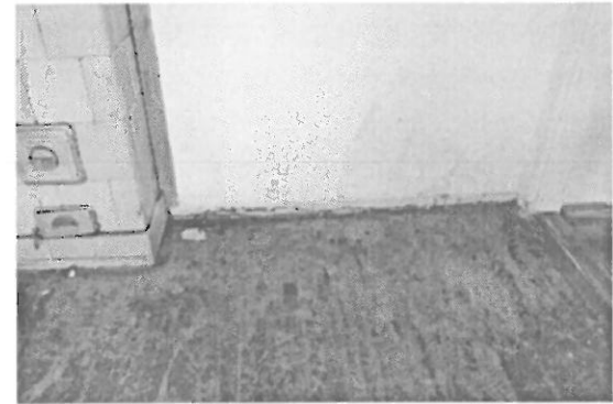
8. sz. kép. A beton padozat megsüllyedt.
