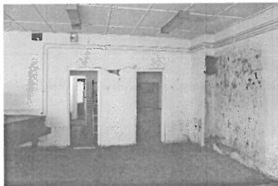
5. sz. kép. A vizesblokk és a nagyterem közötti fal megrepedt.
