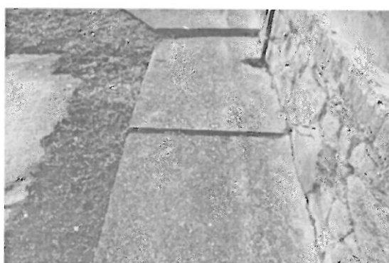
14. sz. kép. AZ utcai járda elemei megsüllyedtek.
