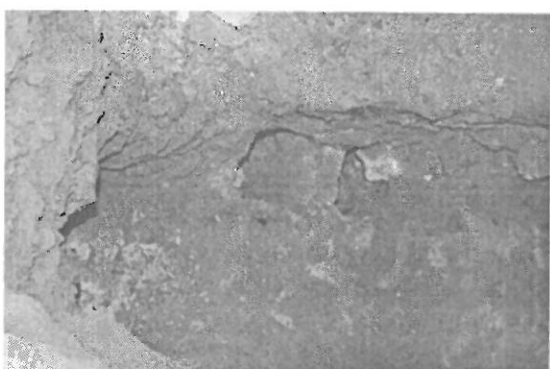
12. sz. kép. Az utca menti feltárás. Látható a boltozaton levő nyílás, a pince nincs ki-tömedékelve.
